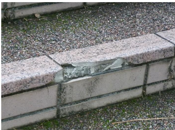
遊歩道階段の破損箇所
