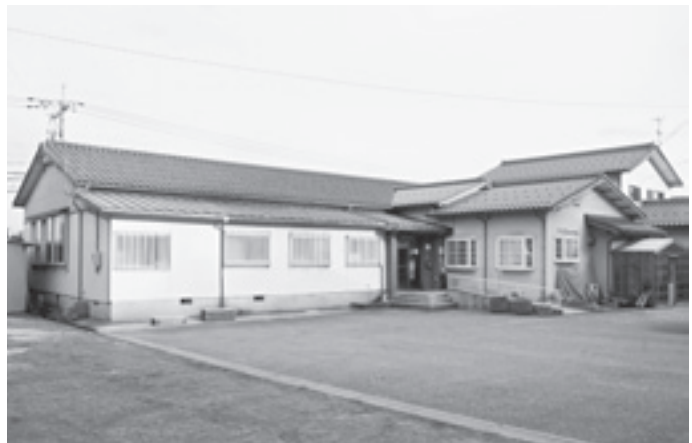
地区唯一の避難施設が耐震不足（室公民館）
