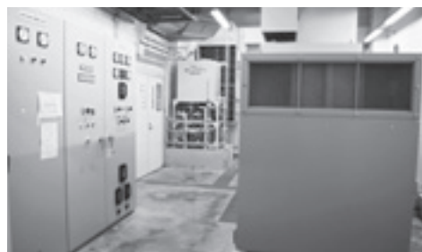
役場地下に設置されている発電設備
