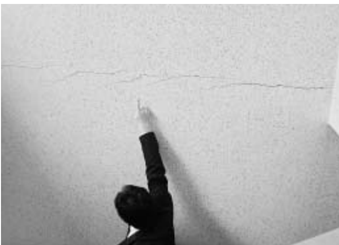
福祉センター本館の階段部分に生じているひび割れ
