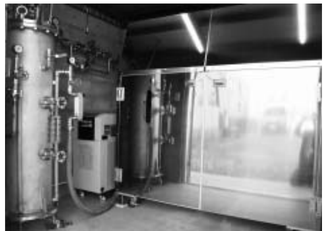
水を主原料とした水素と化石燃料を混合させる燃料システム(温水プール)
