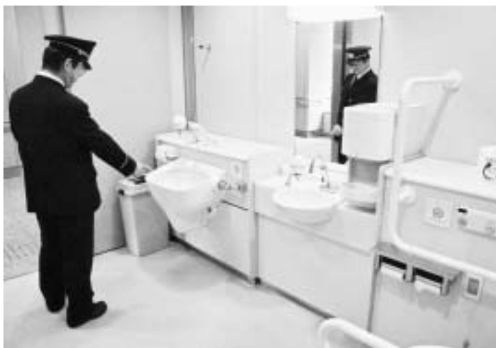
石川県庁舎に設置されているオストメイト対応トイレ
