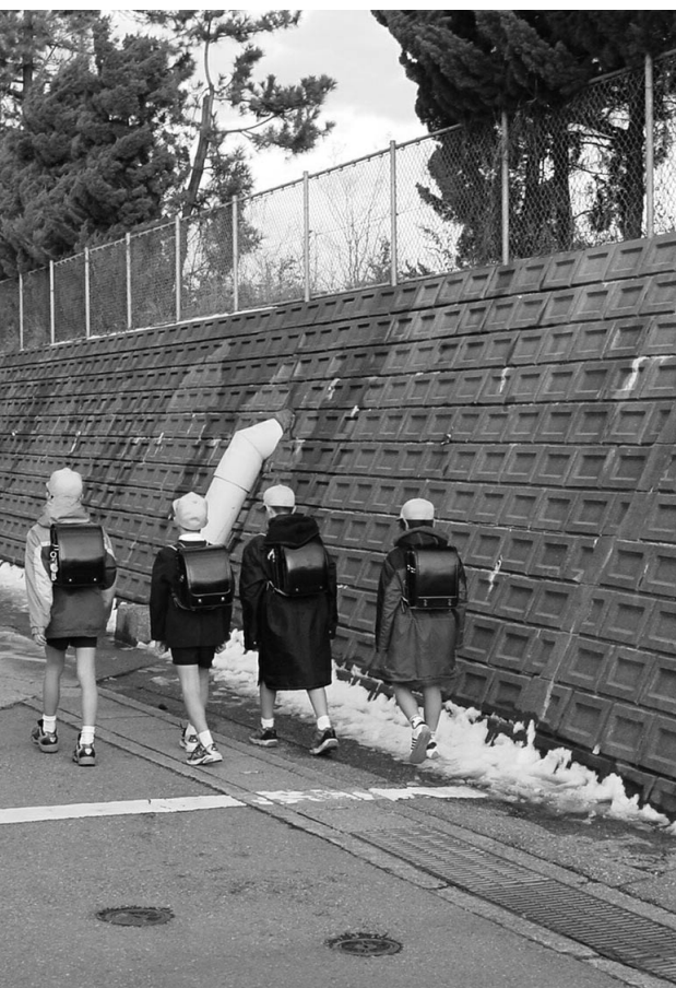
早急に改修が待たれる擁壁
